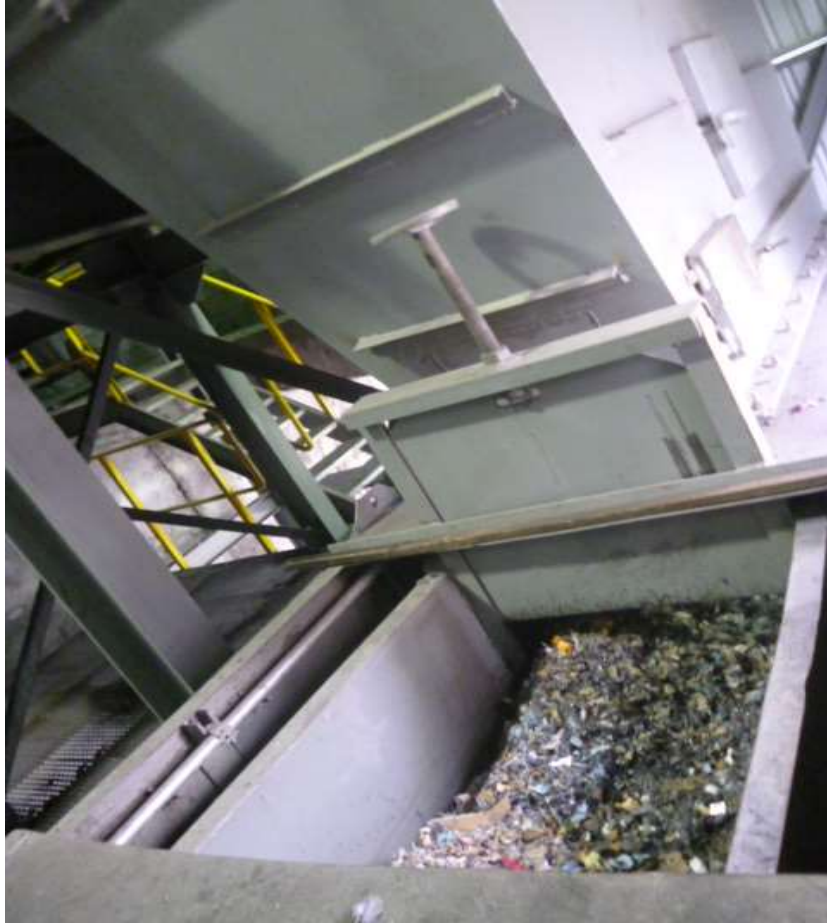
Tolva con descarga hacia banda pesadora
